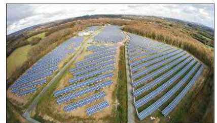
Ferme solaire Le Cosquer – Plounévez-Moëdec (22) Centrale solaire au sol de 2,66 MWc Mise en service : 2021
