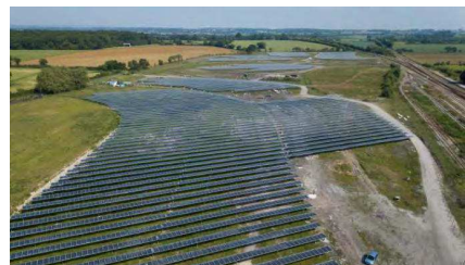
Site SNCF de Surdon – Château d'Almenêches (61) Centrale solaire photovoltaïque de 6,3 MWc Mise en service : 2018
