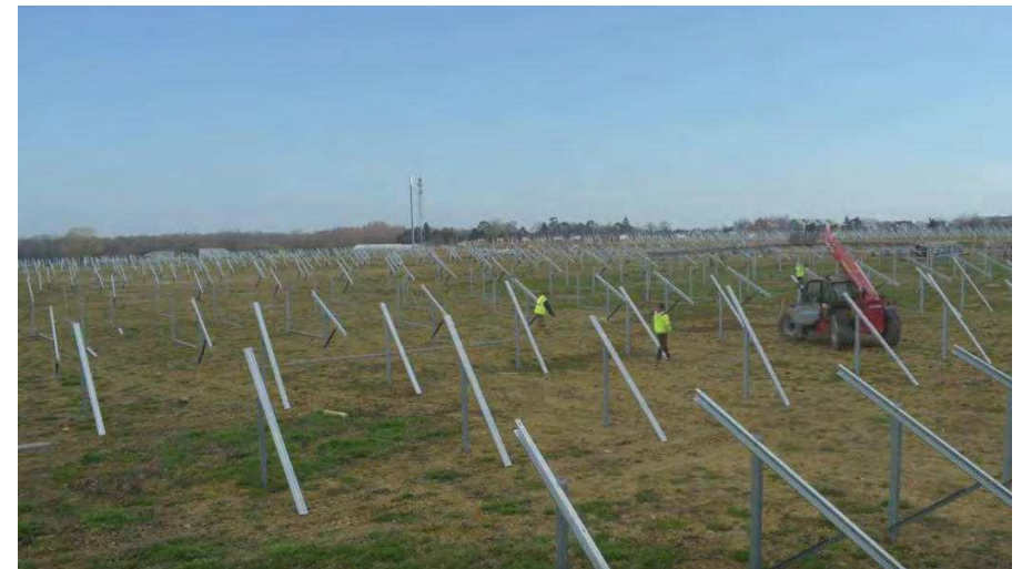
Figure 29 : Assemblage des structures porteuses - photos de la construction de la FS Marc Energies, une réalisation IEL
