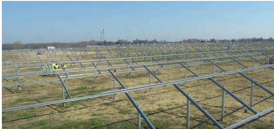
Figure 30 : Assemblage des structures porteuses - photos de la construction de la FS Marc Energies, une réalisation IEL
