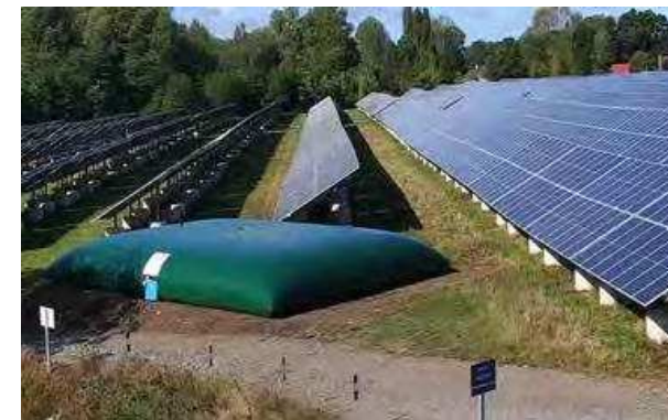
Figure 24 : Citerne incendie 60 m3 de la centrale photovoltaïque au sol du Gravier à Aubigné-Racan (72), une réalisation IEL
