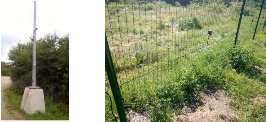
Figure 22 : Système de vidéo-surveillance avec détection infrarouge (à gauche) et du câble de détection (à droite) – photos prises sur les centrales solaires d'IEL à Machecoul (44) et à Descartes (37)
