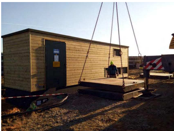
Figure 36 : Poste de livraison avec bardage bois, projet en phase travaux (source : IEL)
