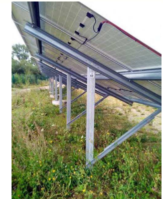
Figure 33 : Câblage intégré aux structures (Bruz)
